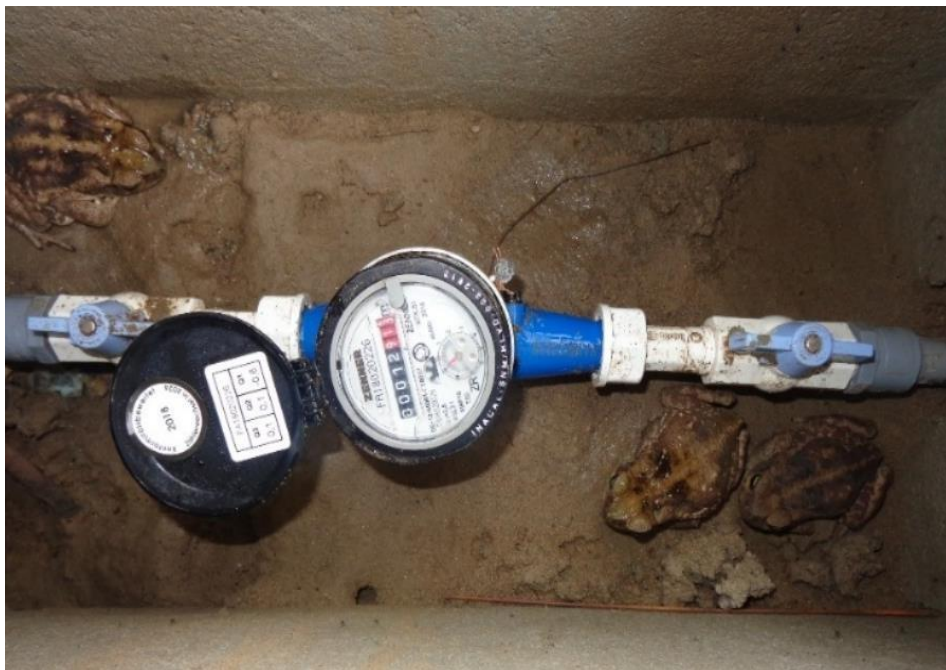
FIGURA 37: Inspección de micromedidores de agua, Localidad de Bellavista.
