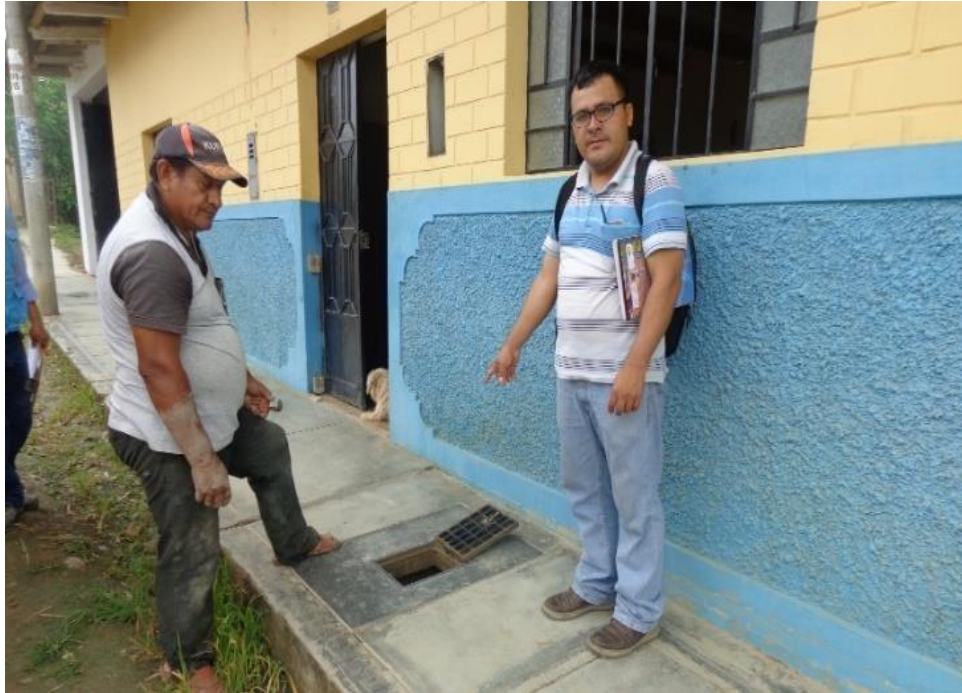
FIGURA 36: Inspección de micromedidores de agua, Localidad de Bellavista.
