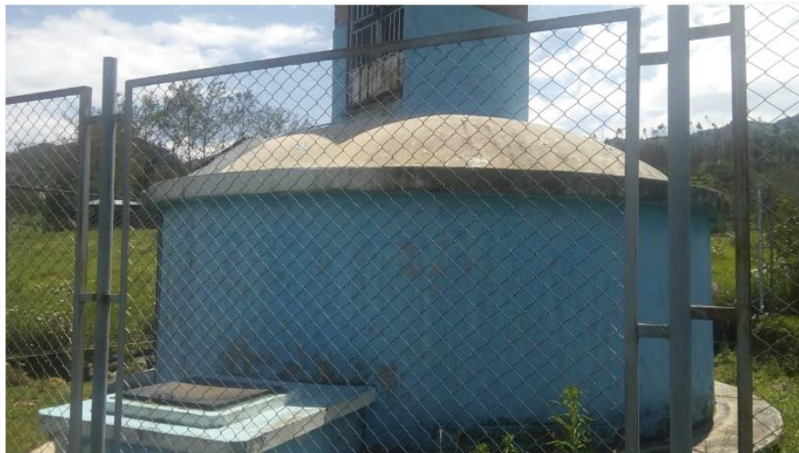
Fotografía 20 Medición de los descensos consumidos en los reservorios
