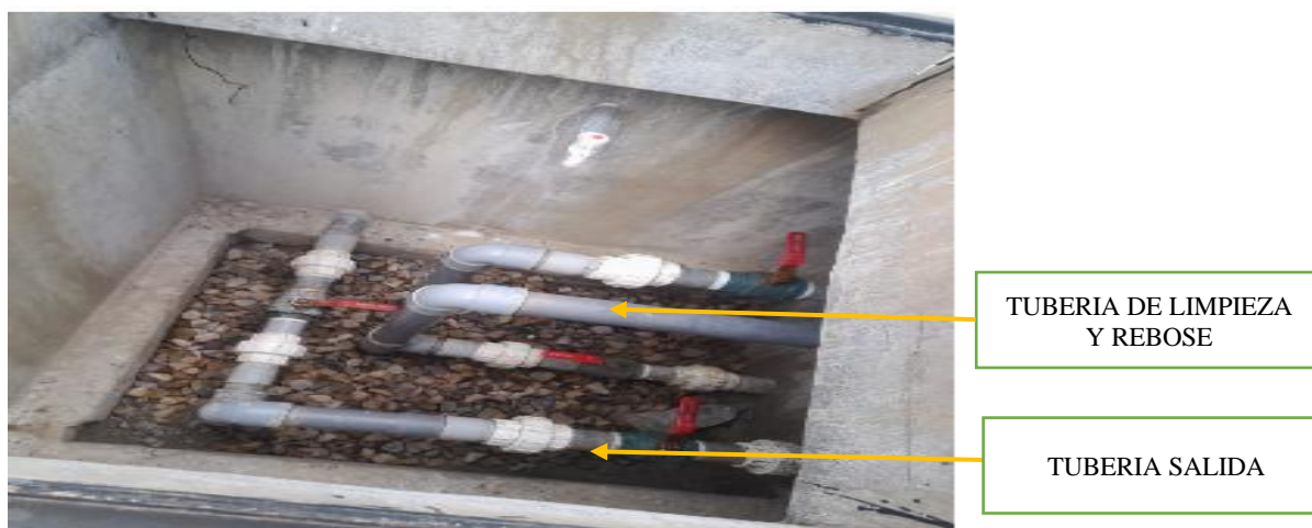
Fotografía 8 a) Vista en el interior de la caja de válvulas en el reservorio N°03 b) Tubería de entrada
