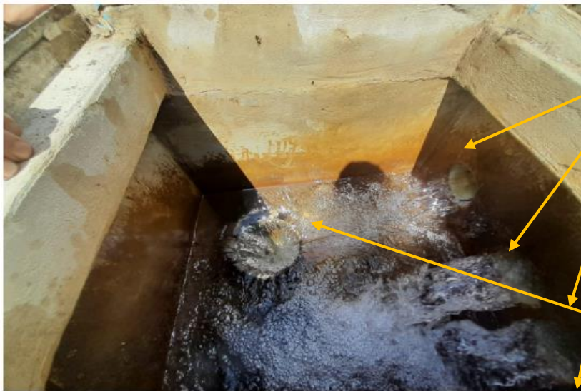
Fotografía 3 Vista de la cámara húmeda de la captación "Alto Mirador"
