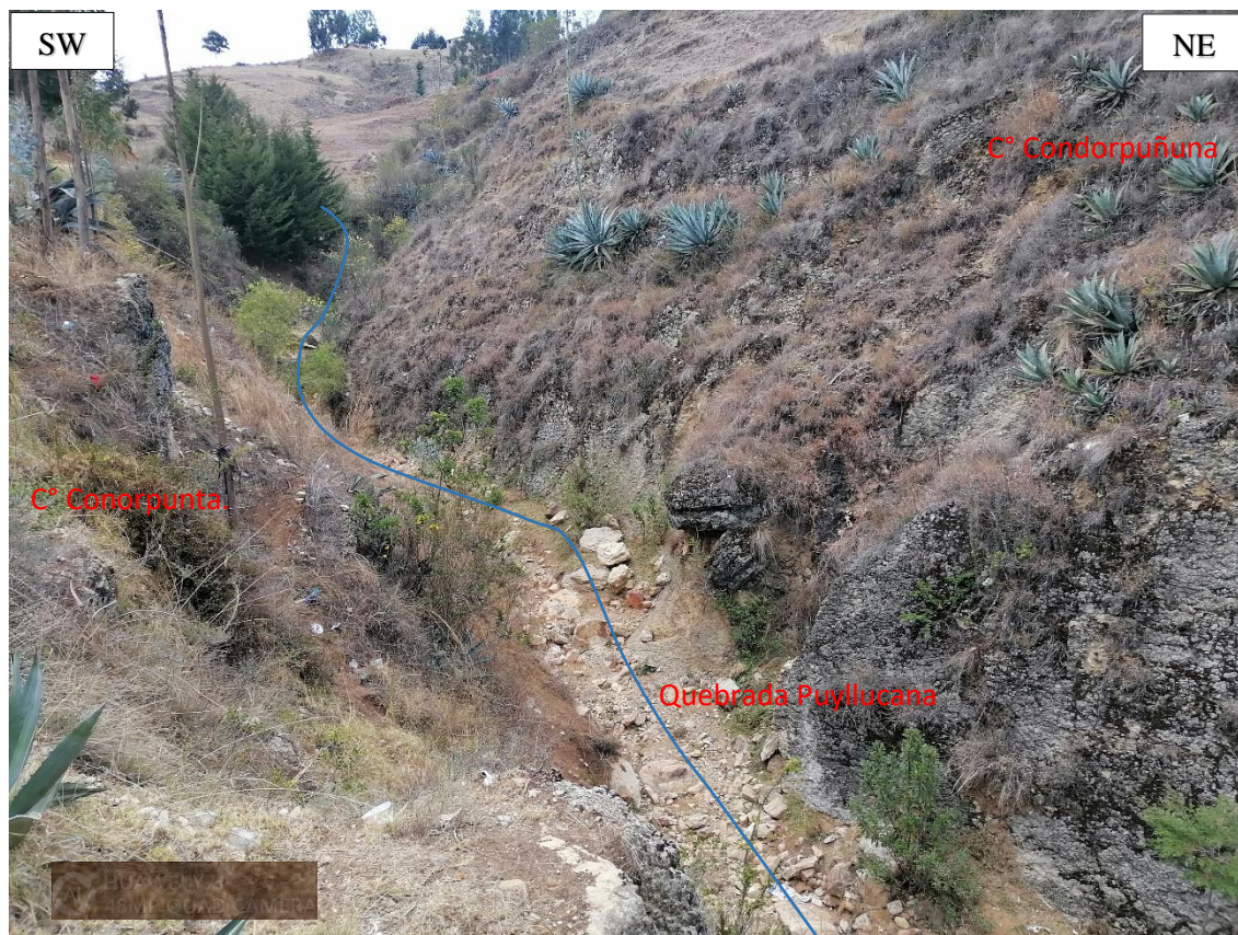
Figura 3.9. Drenaje de la quebrada Puylucana con orientación ESE-WNW, delimitados entre los cerros: Condorpuñuna y Conorpunta. Zona Puylucana.
