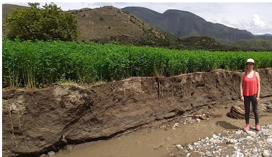
Figura 19. Fotografía de socavación de áreas cultivables en zona inundada en año 2002.
