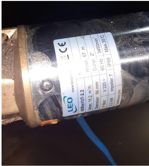
Foto 11: Marca de bomba instalada
