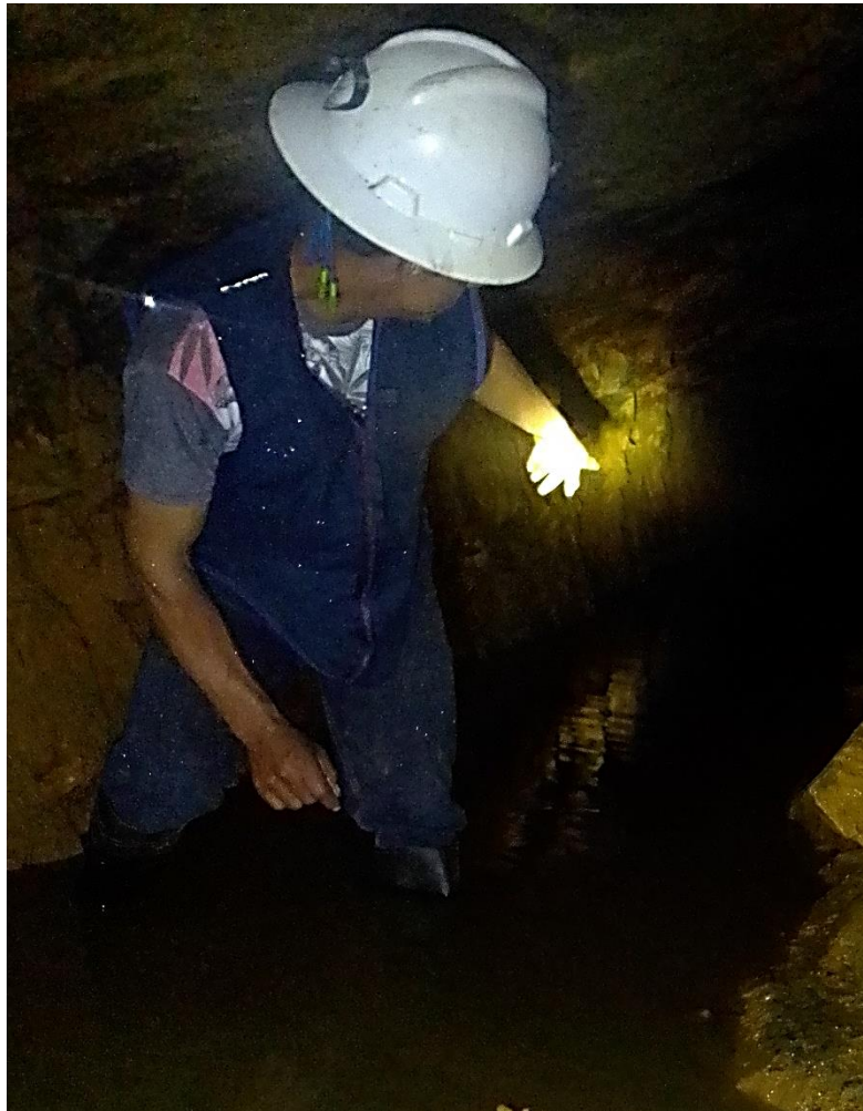
Foto 6: Reconocimiento de la cantidad de agua infiltrada
