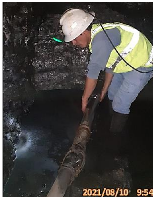
Foto 5: Reconocimiento de la bomba instalada
