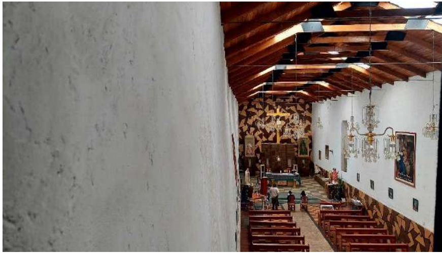
Figura 34. Patología en primer nivel de la iglesia en muro principal
