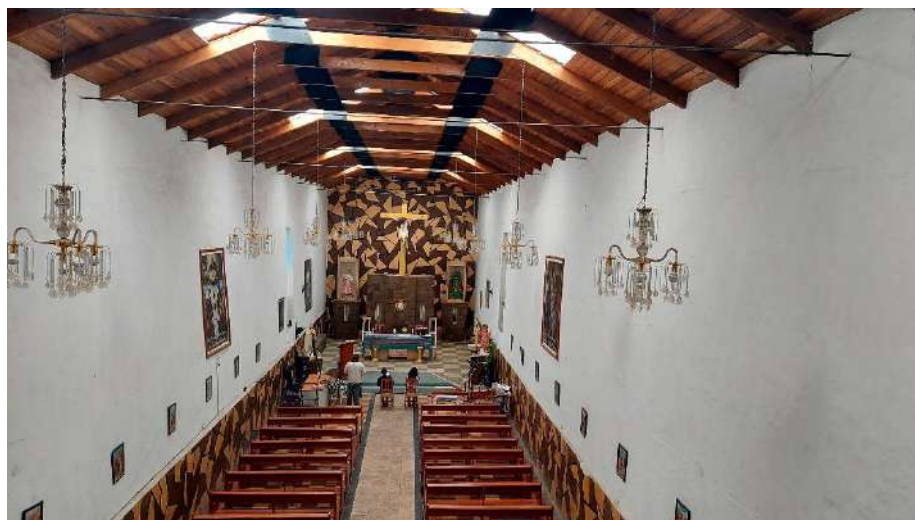
Figura 37. Patologías en el campanario de la iglesia
