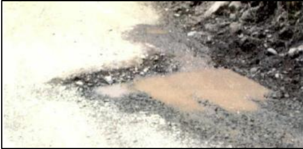
Figura 7. Gravedad 1: Pueden repararse por mantenimiento rutinario Fuente: Manual de Carreteras Mantenimiento o Conservación Vial (2014)
