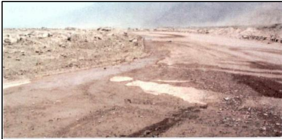
Figura 8. Gravedad 2: Necesita una capa de material adicional Fuente: Manual de Carreteras Mantenimiento o Conservación Vial (2014)
