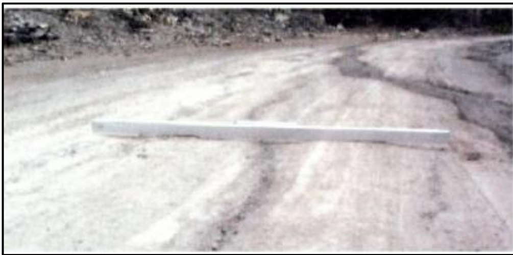
Figura 4. Gravedad 1: Sensible al usuario pero profundidad < 5 cm Fuente: Manual de Carreteras Mantenimiento o Conservación Vial (2014)
