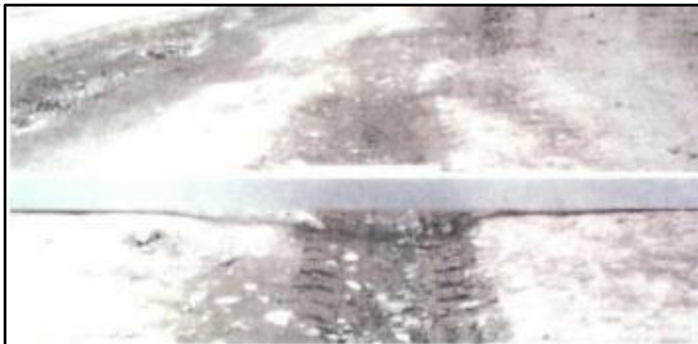
Figura 5. Gravedad 2: Profundidad entre 5 cm y 10 cm
