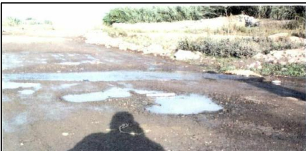
Figura 9. Gravedad 3: Necesita una reconstrucción Fuente: Manual de Carreteras Mantenimiento o Conservación Vial (2014)
