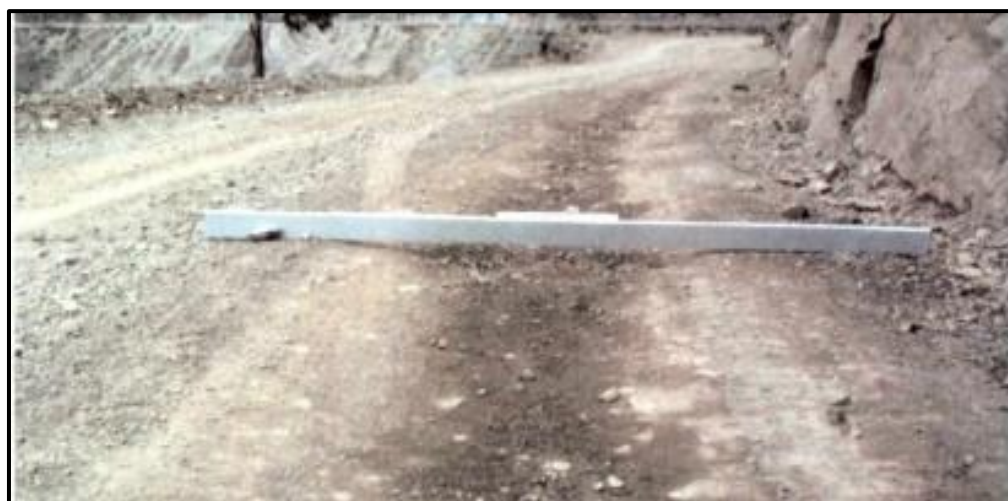
Figura 3. Gravedad 3: Huellas/hundimientos \geq 10 cm
