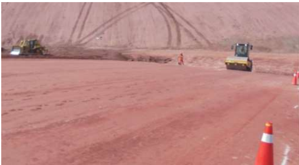
Foto 4: Impermeabilización de la base en la ampliación del PAD II de lixiviación Cuajone
