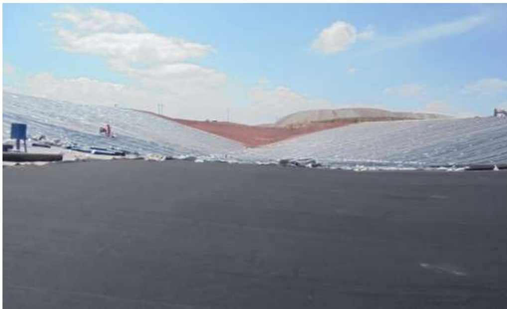
Foto 5: Colocación de Geotextil en la ampliación del PAD II de lixiviación Cuajone
