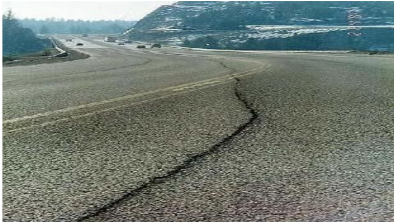
Figura 10 Falla tipo: Fisuras longitudinales y transversales
