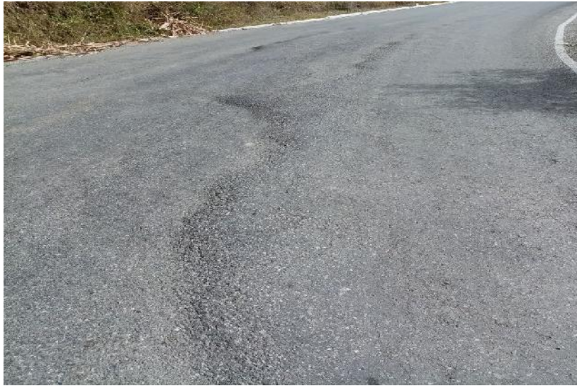
Figura 12 Falla tipo: Abultamientos y hundimientos
