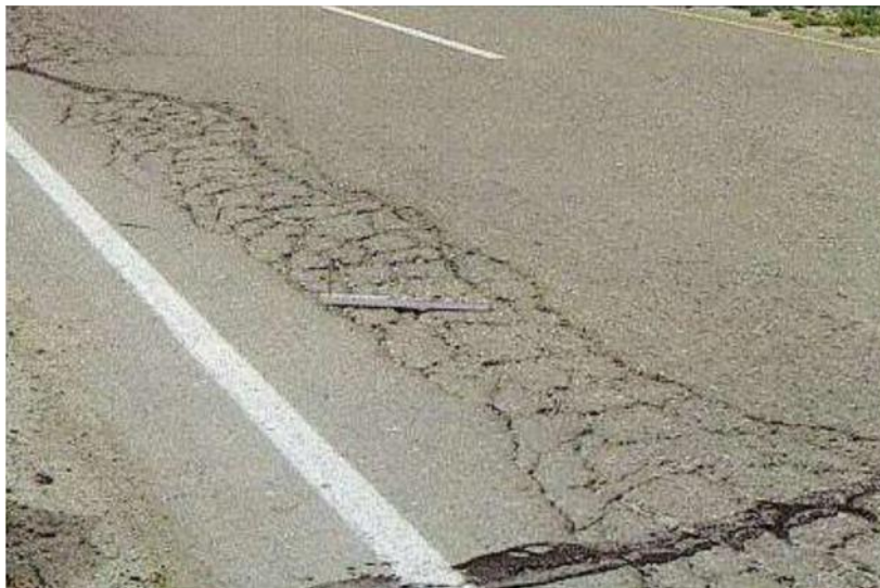
Figura 6 Falla tipo:Piel de cocodrilo
