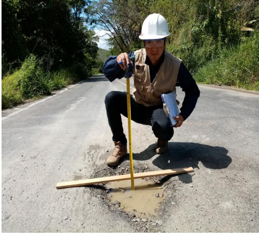
Fotografía 05. Falla tipo baches.
