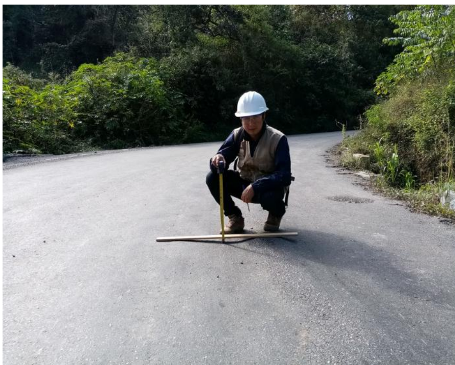
Fotografía 02,03. Falla tipo abultamientos y hundimientos.
