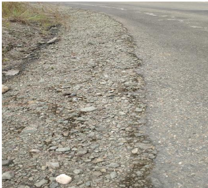
Figura 8 Falla tipo: Fisuras de borde
