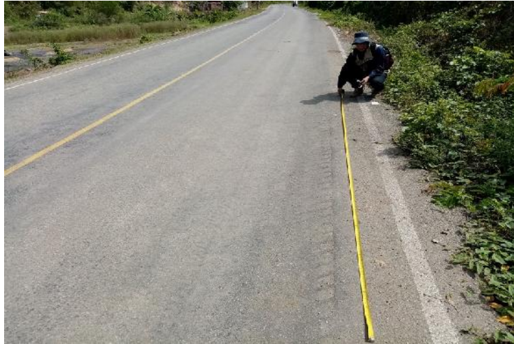
Figura 15 Falla tipo: Ahuellamiento
