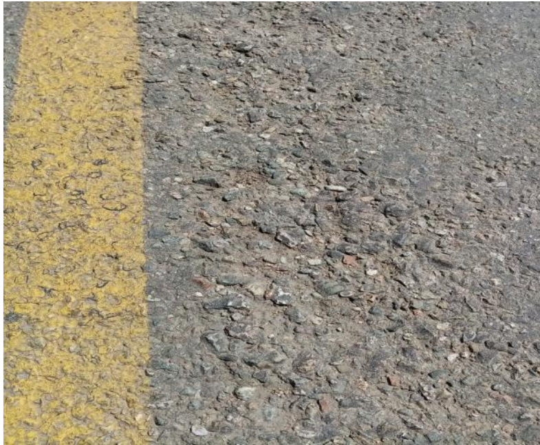
Figura 19 Falla tipo: Peladura por intemperismo y desprendimiento de agregados
