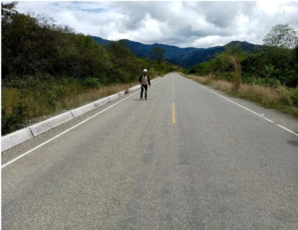
Fotografía 06. Peladura por intemperismo y desprendimiento de agregados.
