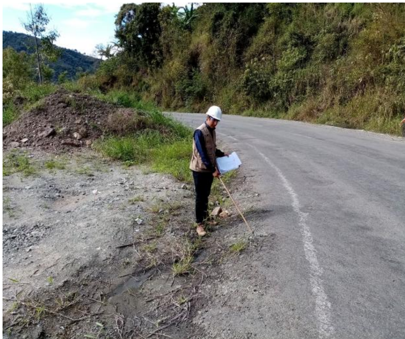
Figura 22 Falla tipo: Desnivel Carril - Berma
