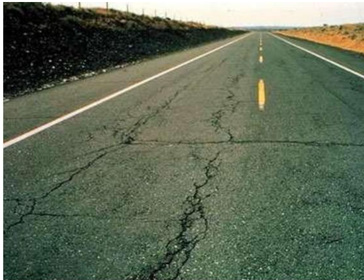
Figura 7 Falla tipo: Fisuras en bloque
