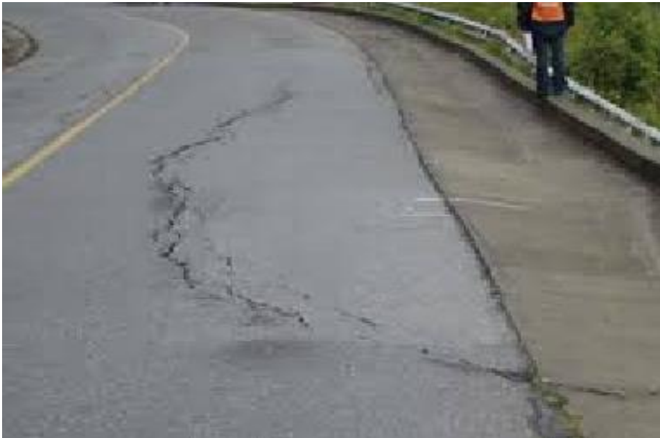
Figura 11 Fisura parabólica o por deslizamiento
