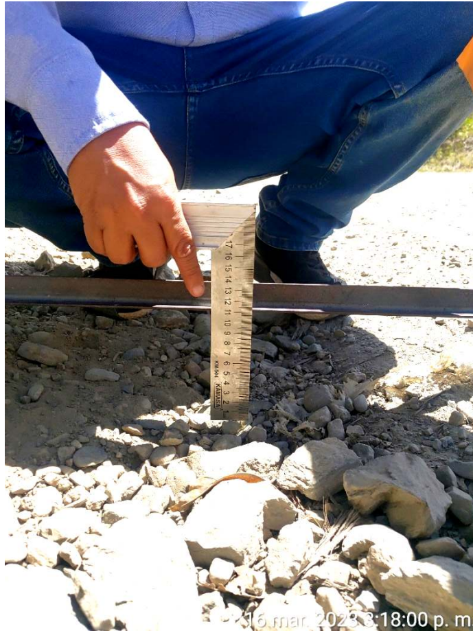
Figura 31 .- Erosión de gravedad 3, ubicada en la sección KM (3+000-3+500)
