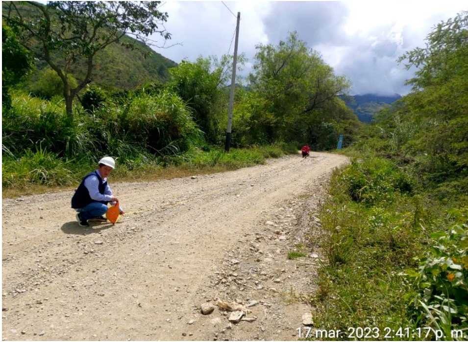
Figura 41 .- Erosión de gravedad 2, ubicada en la sección KM (5+500-6+000)
