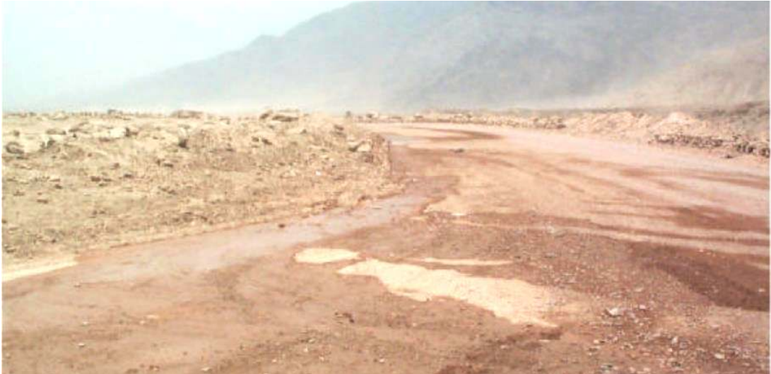
Figura 8 .- Gravedad 2: Necesita una capa de material adicional
