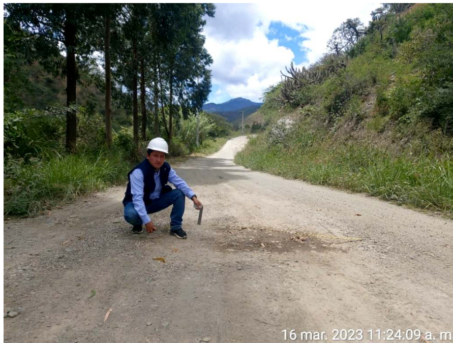
Figura 26 .- Baches de gravedad 2, ubicada en la sección KM (2+000-2+500)
