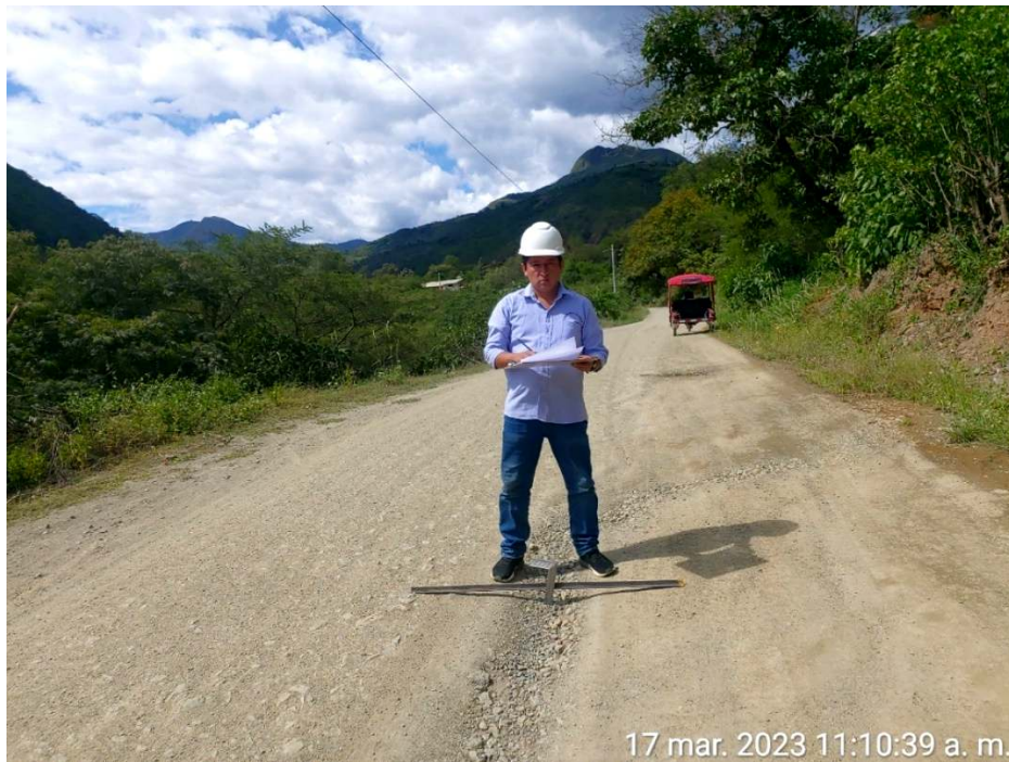
Figura 34 .- Erosión de gravedad 2, ubicada en la sección KM (4+000-4+500)
