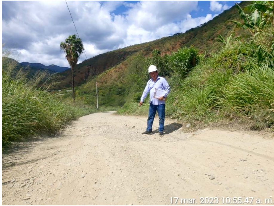
Figura 33 .- Baches de gravedad 3, ubicada en la sección KM (3+500-4+000)
