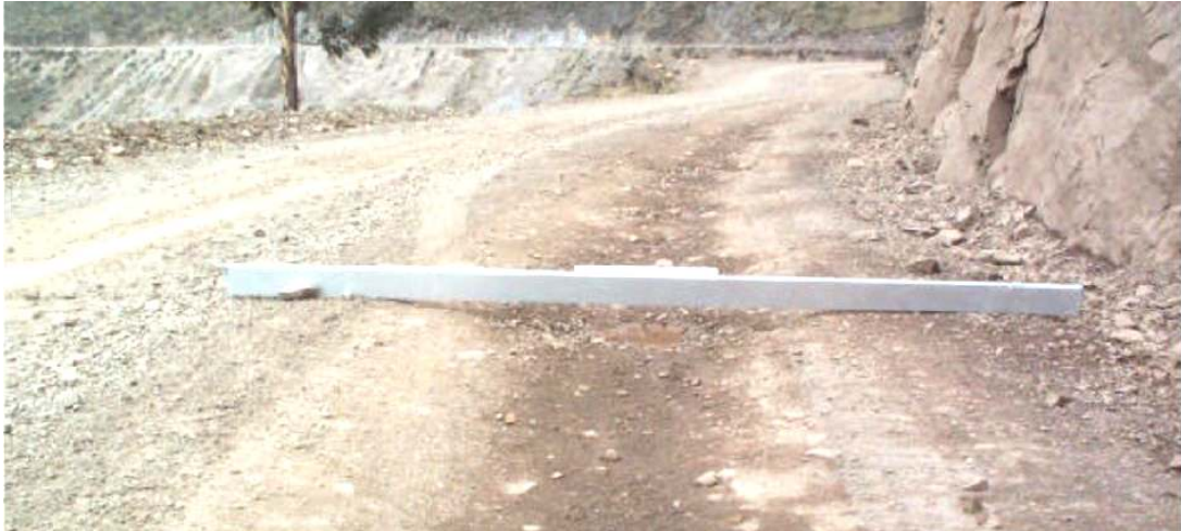
Figura 3.- Gravedad 3: Huellas/hundimientos \geq 10 cm.
