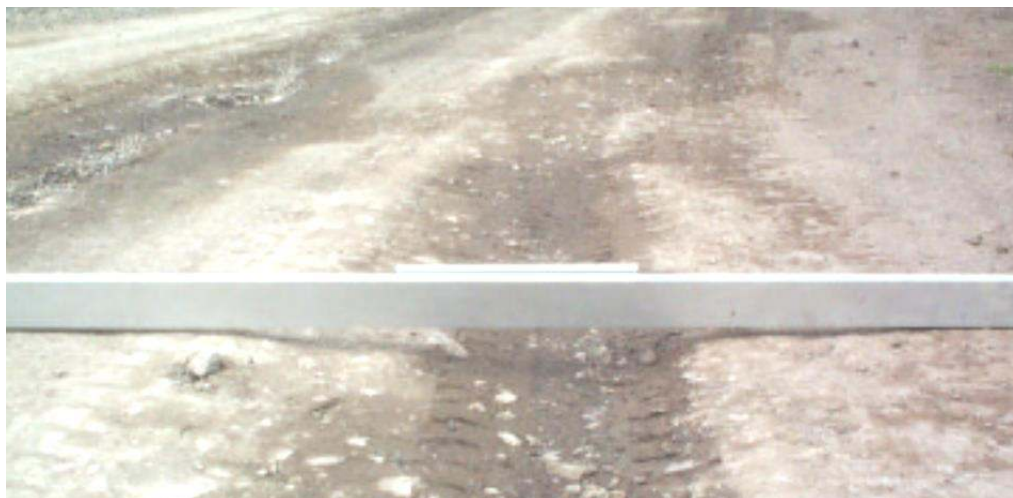
Figura 5 .- Gravedad 2: Profundidad entre 5 cm y 10 cm.
