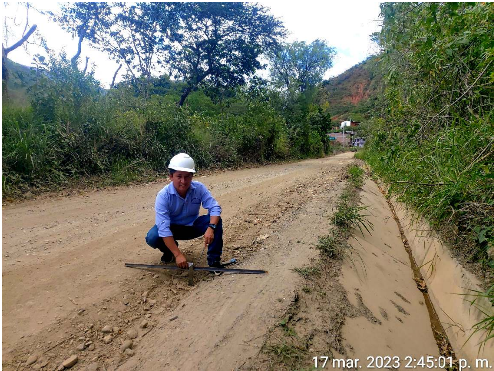
Figura 42 .- Erosión de gravedad 3, ubicada en la sección KM (5+500-6+000)
