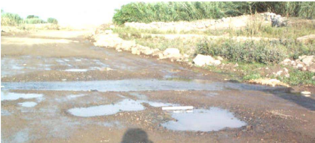
Figura 9 .- Gravedad 3: Necesita una reconstrucción
