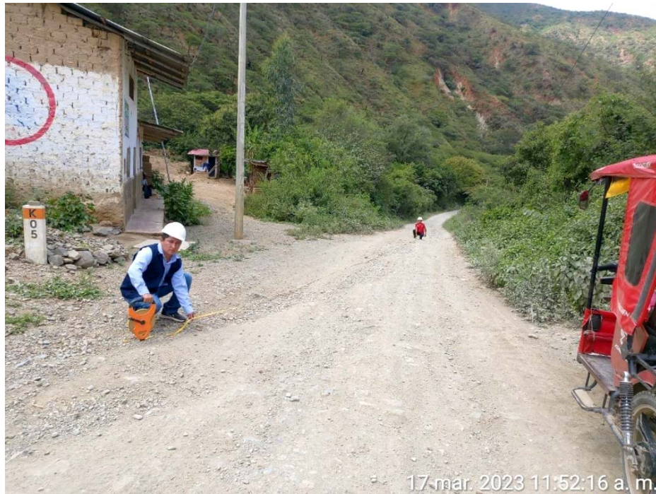
Figura 36 .- Medición de la Erosión de gravedad 2, ubicada en la sección KM (4+500-5+000)
