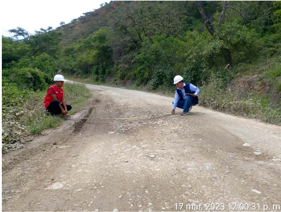
Figura 37 .-Baches de gravedad 2, ubicada en la sección KM (4+500-5+000)
