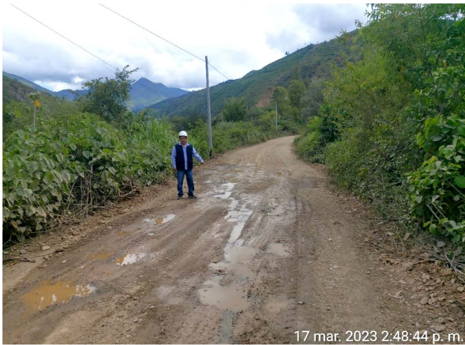
Figura 40 .- Baches de gravedad 2, ubicada en la sección KM (5+000-5+500)
