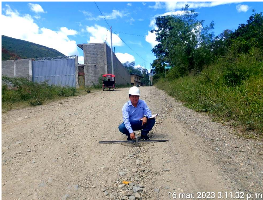
Figura 30 .- Erosión de gravedad 2, ubicada en la sección KM (3+000-3+500)
