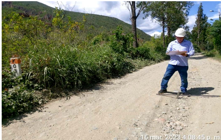
Figura 32 .- Erosión de gravedad 3, ubicada en la sección KM (3+000-3+500)
