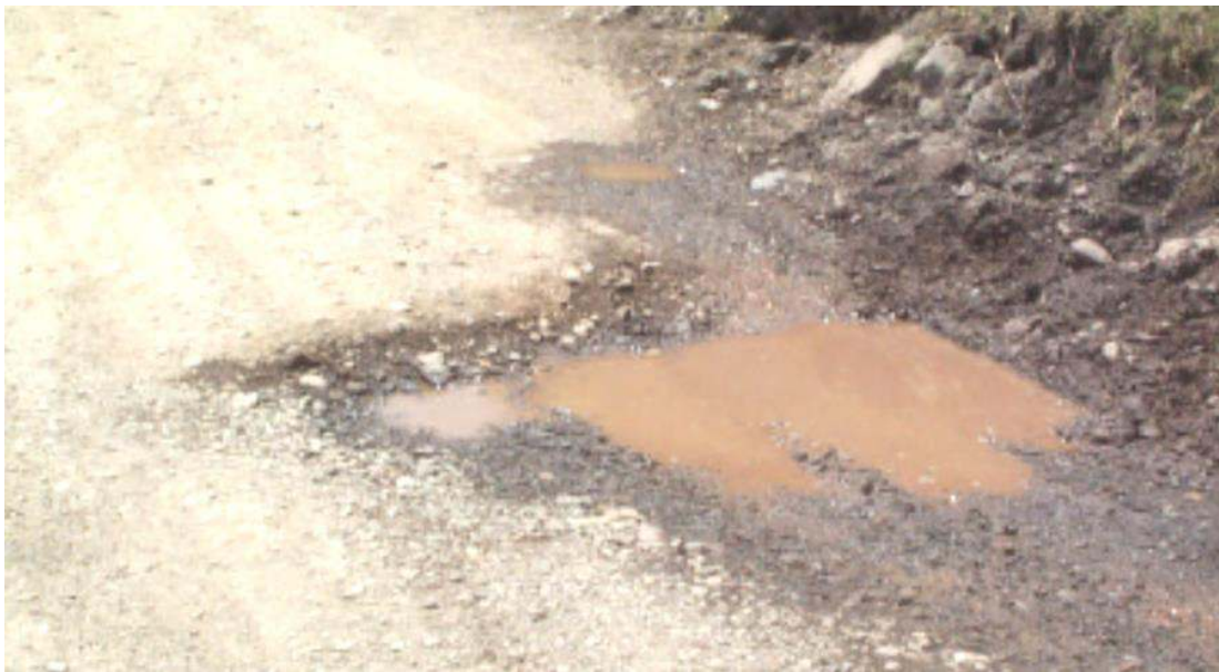
Figura 7 .- Gravedad 1: Pueden repararse por mantenimiento rutinario
