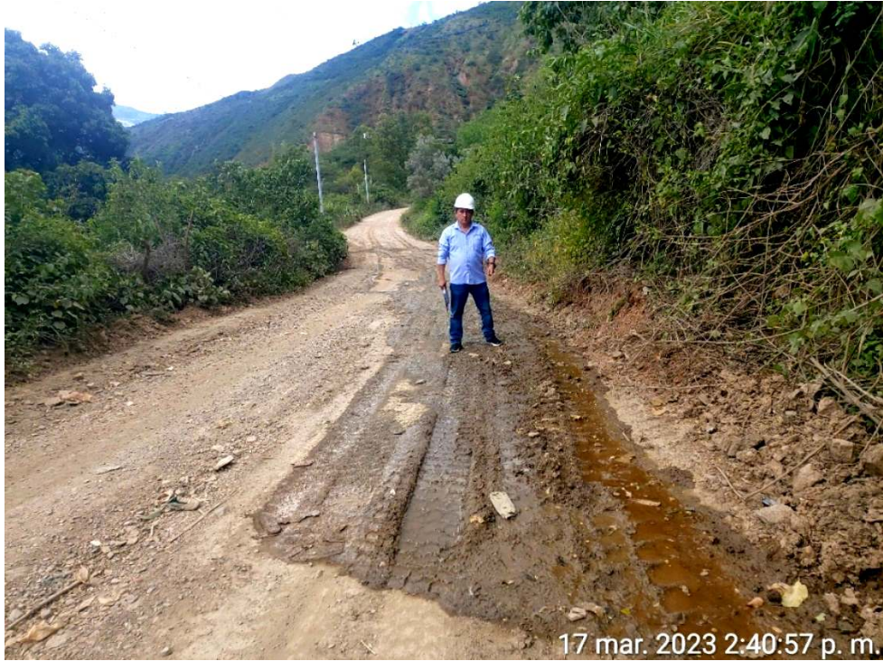
Figura 39 .- Lodazal, ubicada en la sección KM (5+000-5+500)
