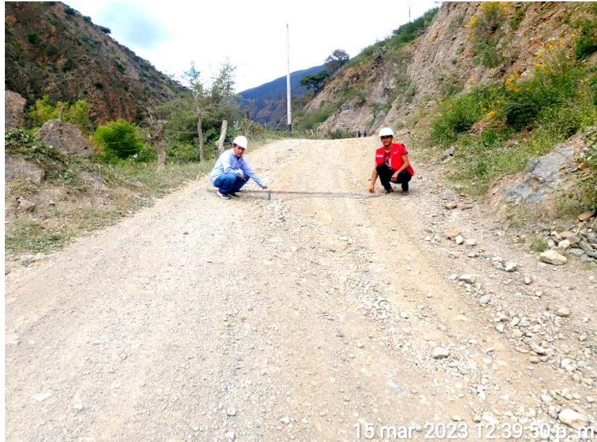
Figura 23 .- Erosión de gravedad 2, ubicada en la sección KM (1+000-1+500)
