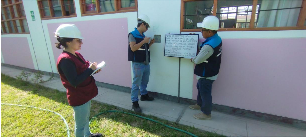
FOTOGRAFÍA N°4 Ensayo 4- MOD.IV: Columna N°2 Entre eje 13-13 y B-B
