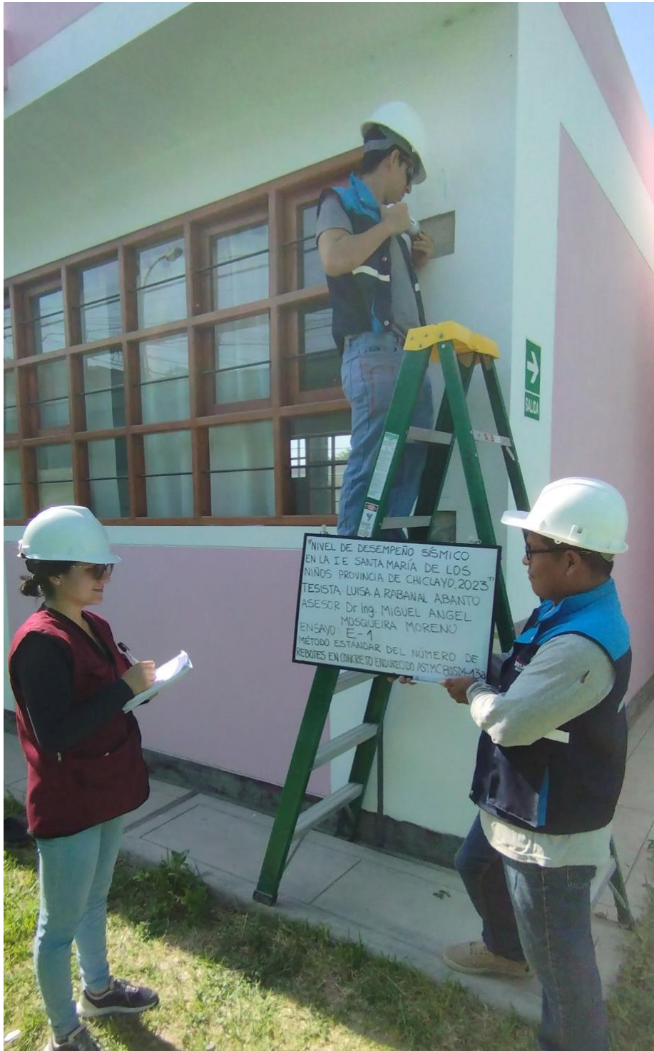
FOTOGRAFÍA N°1 Ensayo 1- MOD.IV: Columna N°1 Entre eje 8-8 y B-B
