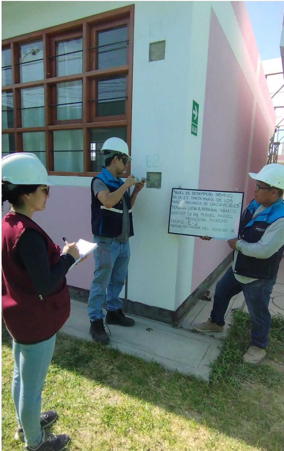
FOTOGRAFÍA N°2 Ensayo 2- MOD.IV: Columna N°1 Entre eje 8-8 y B-B
