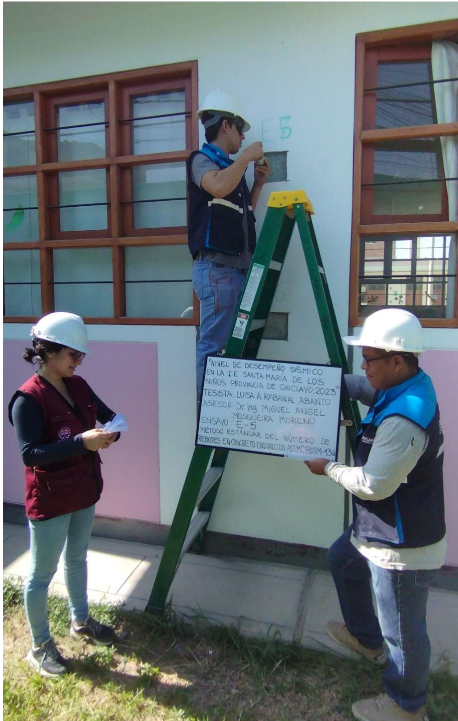
FOTOGRAFÍA N°6 Ensayo 5-MOD.IV: Columna N°3 Entre eje 17-17 y B-B
