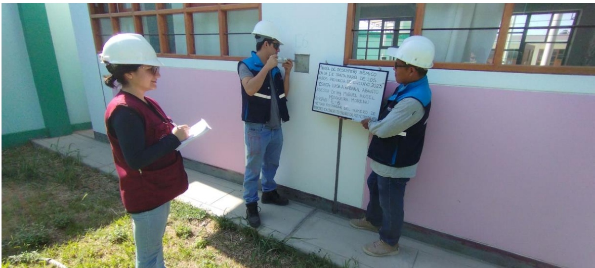
FOTOGRAFÍA N°5 Ensayo 6- MOD.IV: Columna N°3 Entre eje 17-17 y B-B
