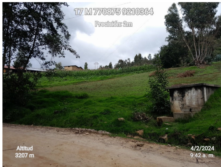
Figura 53. Talud del tramo Km 07+040 al Km 07+114 con cultivos, y pendiente alta
