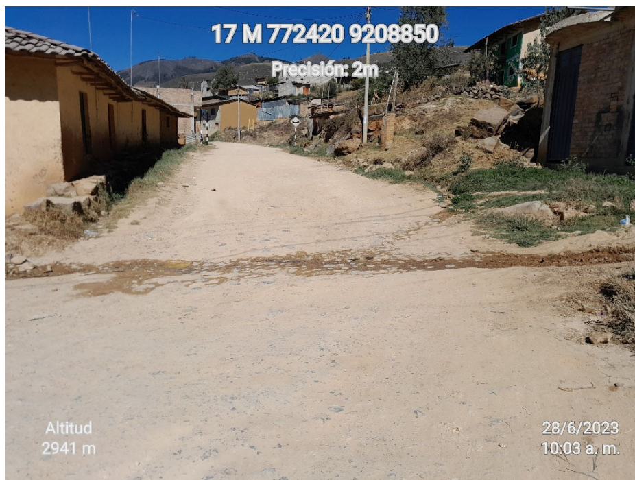
Figura 28. Estado actual de badén N°06
