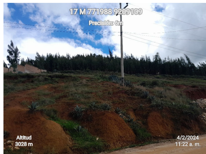
Figura 46. Talud del tramo Km 04+450 al Km 05+000 con hierba y grama, con pendiente alta
