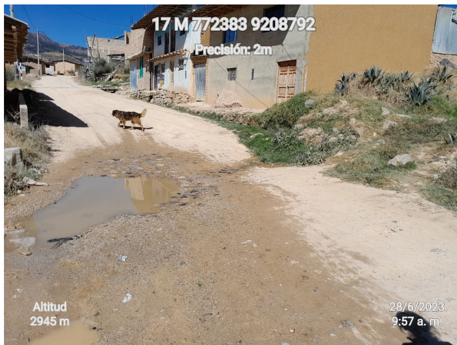
Figura 29. Estado actual de badén N°07
