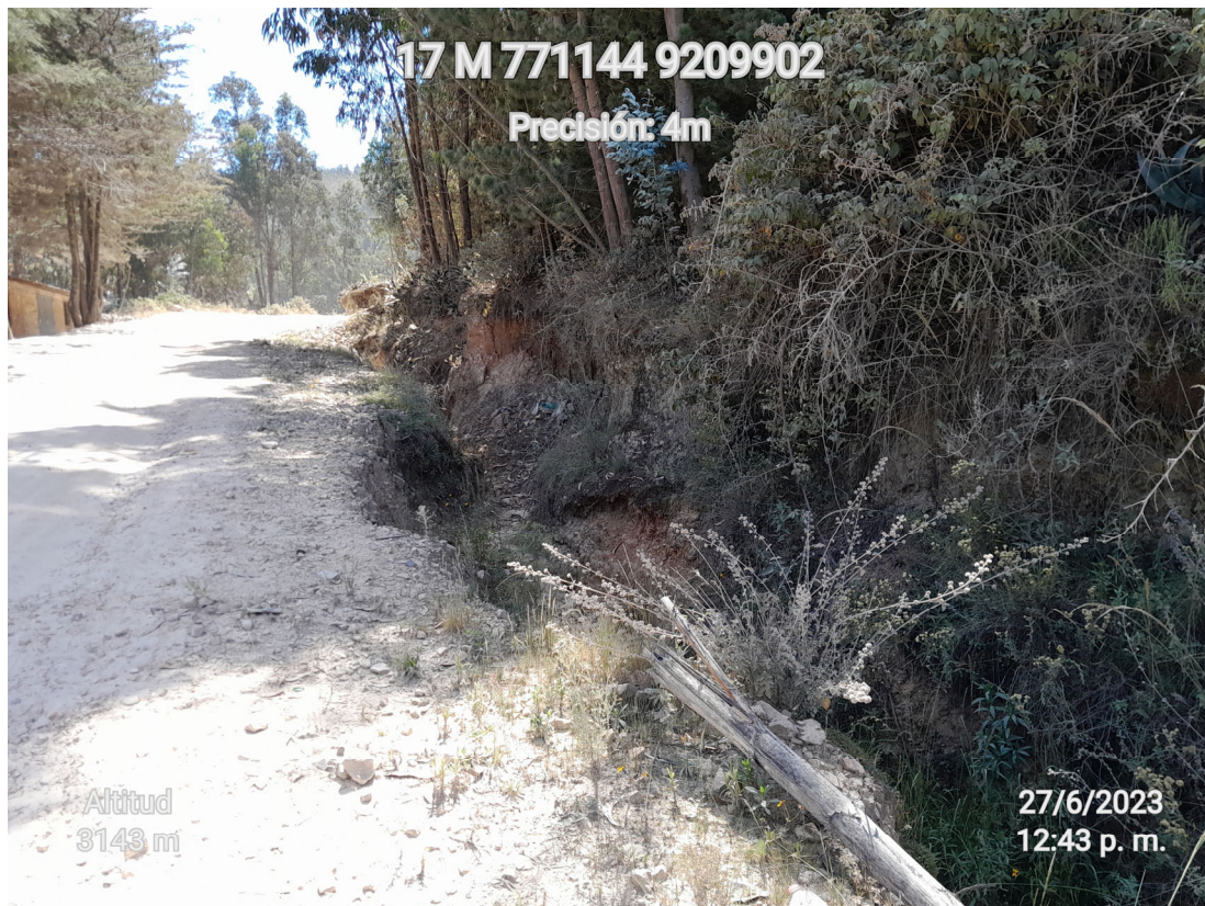
Fotografía N° 4: Erosión de cunetas del Km.06 por lluvias
