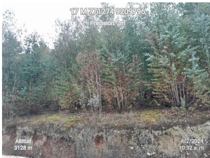
Figura 48. Talud del tramo Km 05+650 al Km 06+085 con bosques y densa vegetación, con pendiente alta
