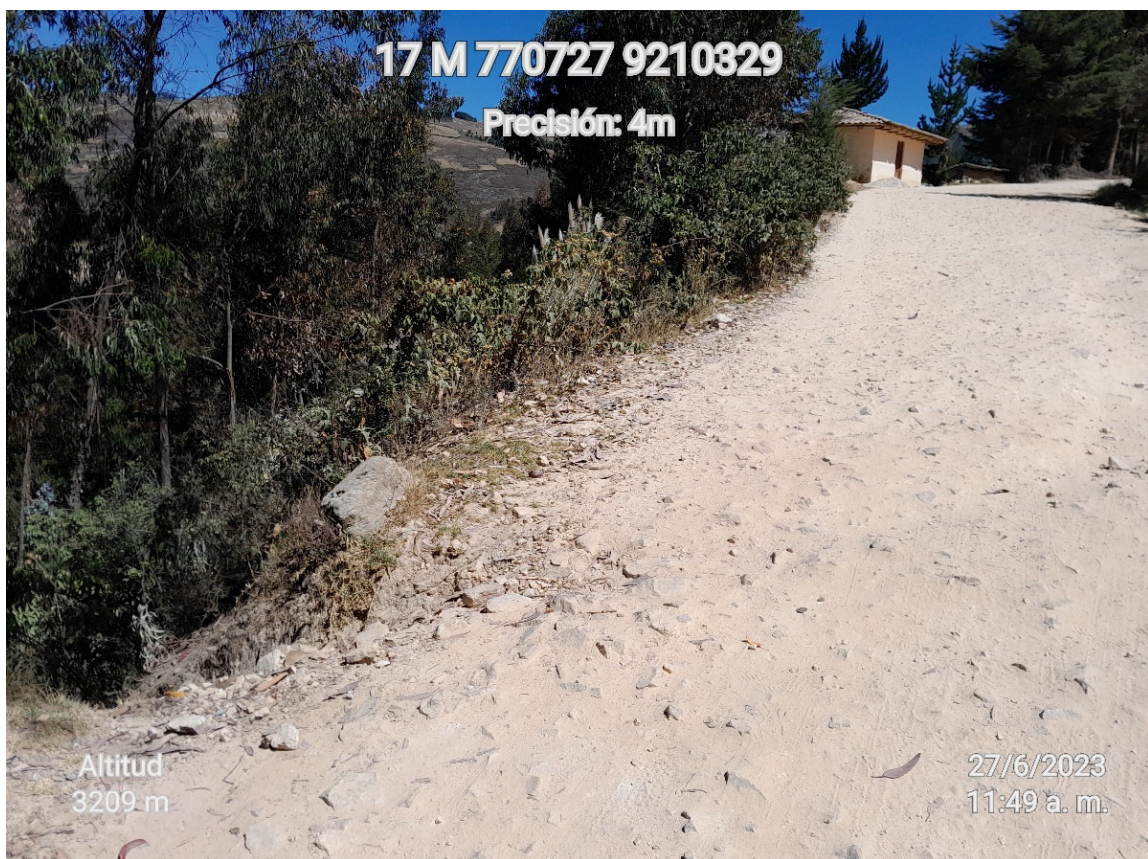
Fotografía N° 6: Afirmado en mal estado por erosión durante lluvias (Km.07)
