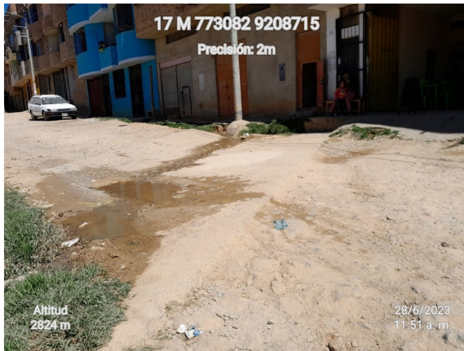
Figura 24. Estado actual de badén N°02
