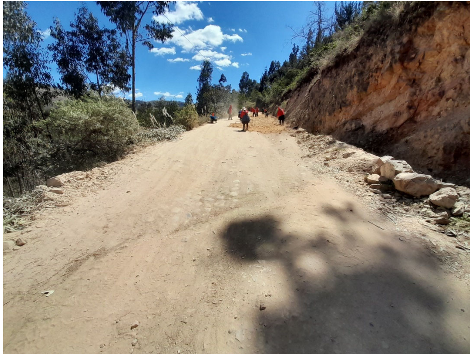
Figura 30. Estado actual de badén N°08
