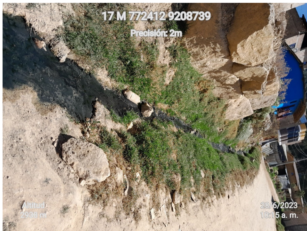
Fotografía N° 2: Aguas servidas en cunetas del Km.03
