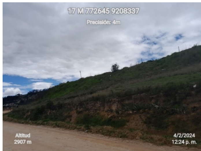
Figura 42. Talud del tramo Km 02+090 al Km 02+636 con hierba y grama, y pendiente pronunciada
