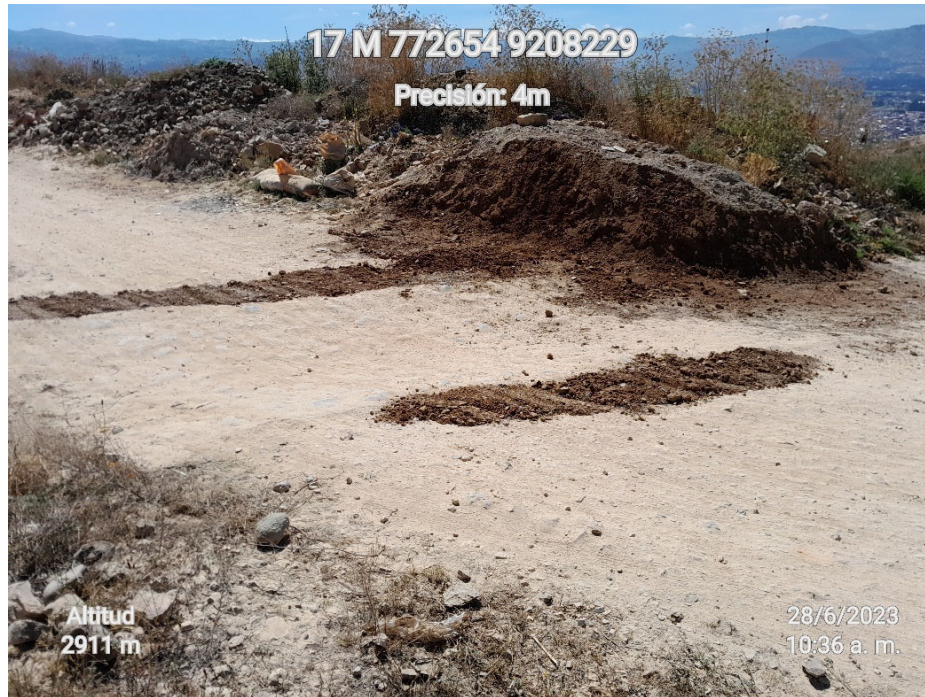
Figura 27. Estado actual de badén N°05
