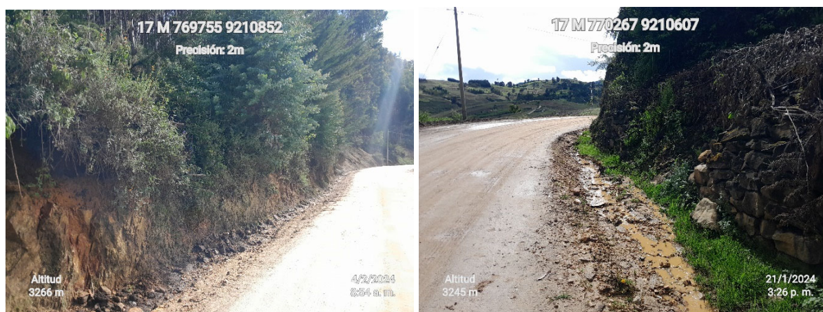
Figura 32. Secciones de cunetas sedimentadas
