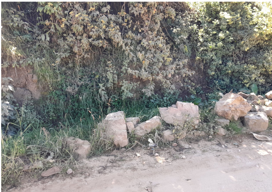
Fotografía N° 8: Talud con presencia de agua, alcantarilla obstruida en Km.08
