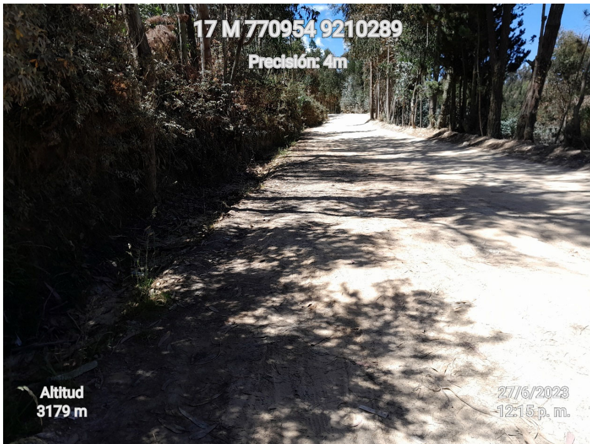
Fotografía N° 5: Plataforma desnivelada por arrastre de materiales durante lluvias (Km.06)
