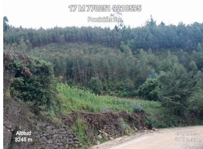
Figura 58. Talud del tramo Km 07+832 al Km 08+075 con bosques y densa vegetación, y pendiente pronunciada
