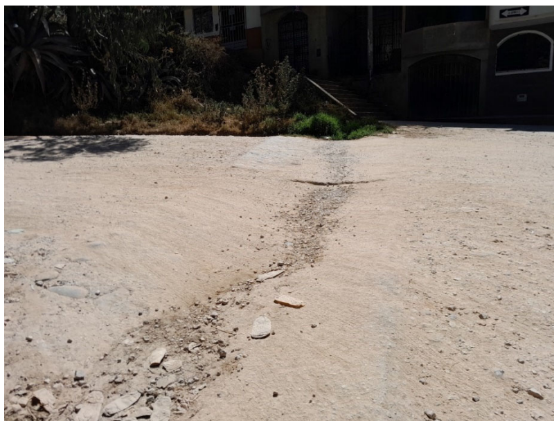
Figura 23. Estado actual de badén N°01
