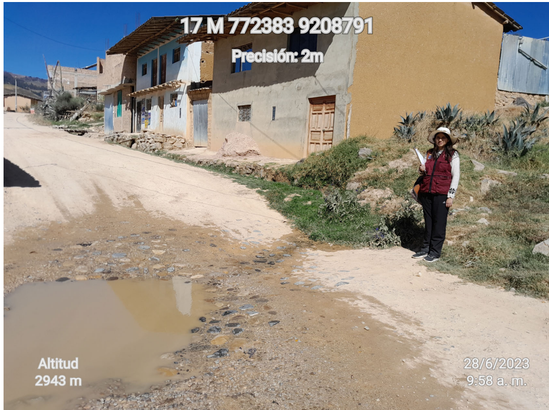
Fotografía N° 3: Estado actual de badén en el Km.03
