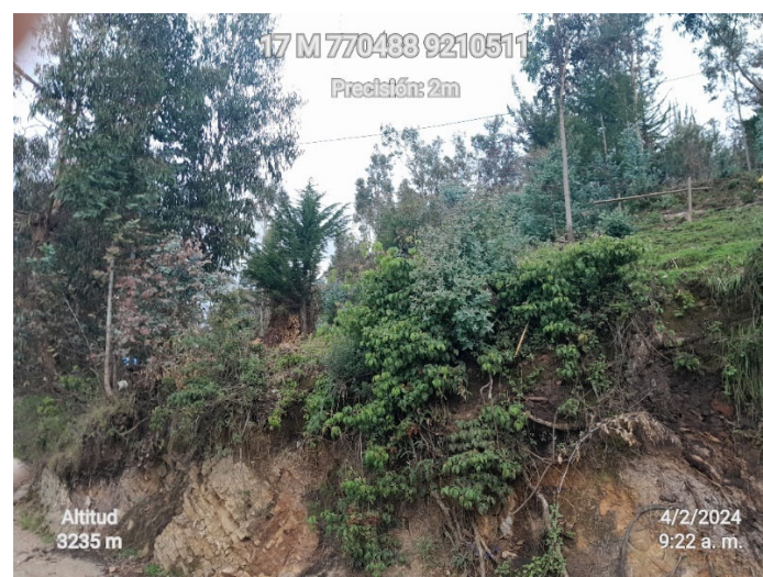
Figura 55. Talud del tramo Km 07+400 al Km 07+531 con pastos y vegetación ligera, y pendiente alta
