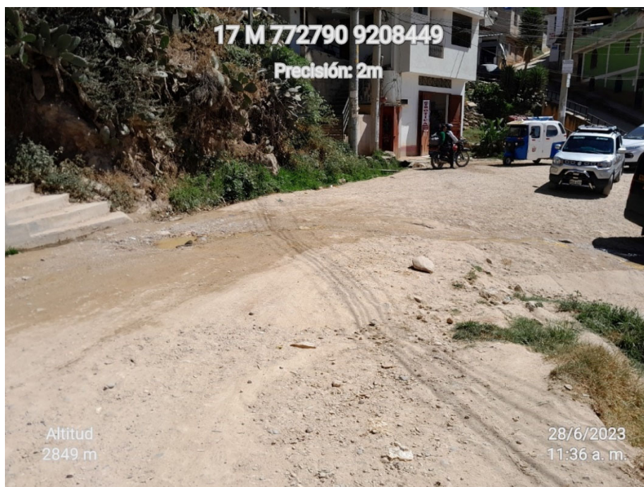
Figura 25. Estado actual de badén N°03
