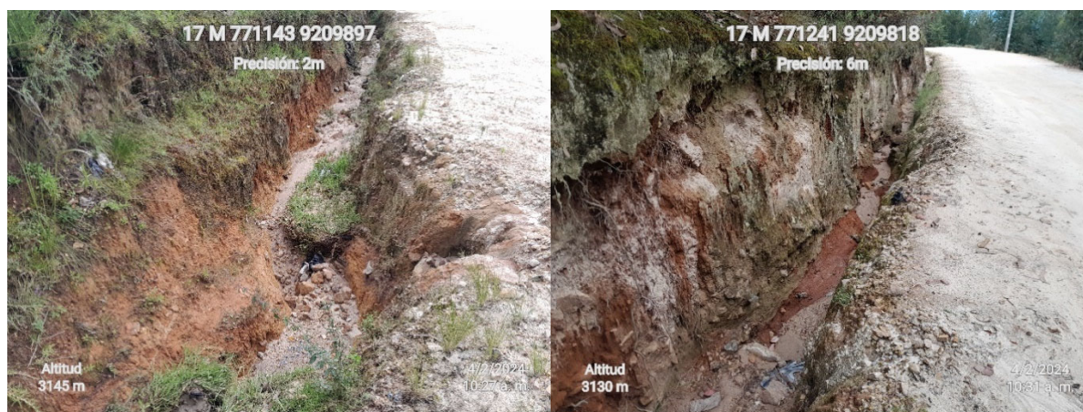
Figura 31. Secciones de cunetas erosionadas
