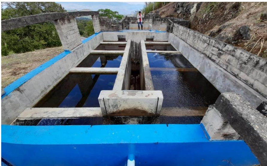
Foto N° 3. Pre filtro de la Planta de tratamiento de agua potable
