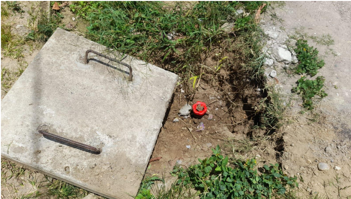
Foto N° 14. Válvula de Control N° 03
