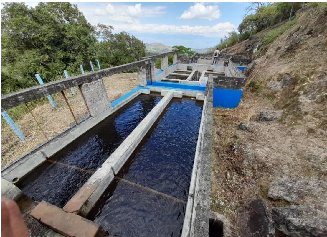
Foto N° 15. Planta de Tratamiento de Agua Potable
