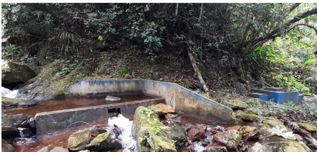
Foto N° 1. Captación El Anguyo
