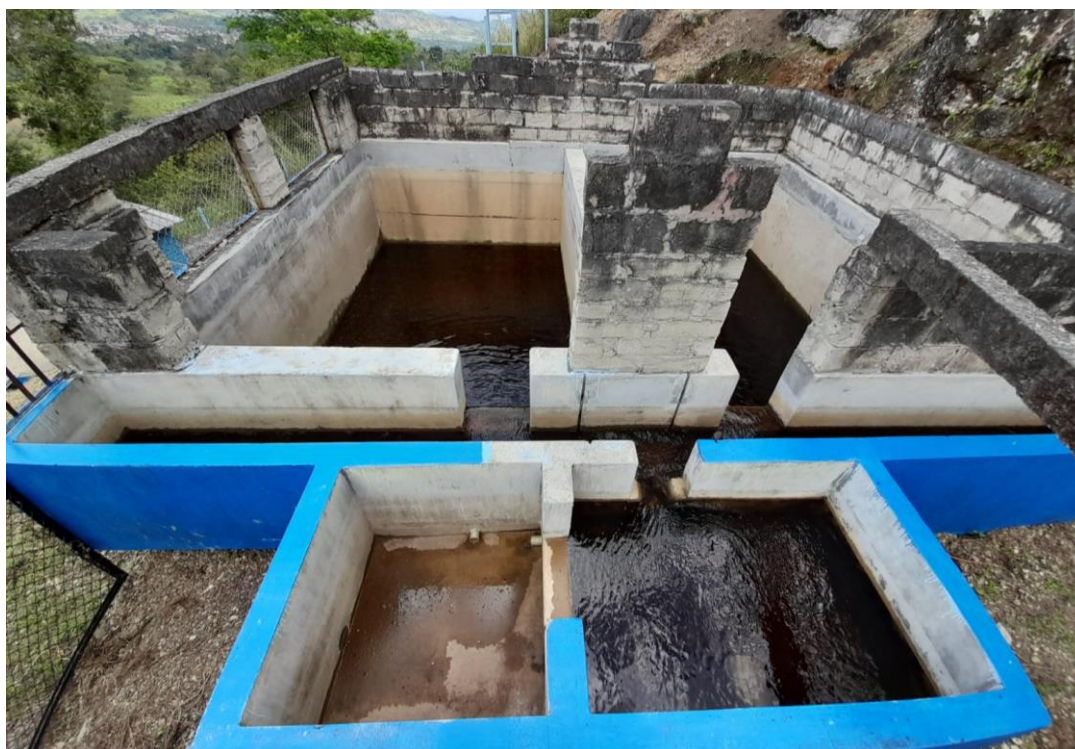
Foto N° 4. Filtro Lento de la Planta de tratamiento de agua potable
