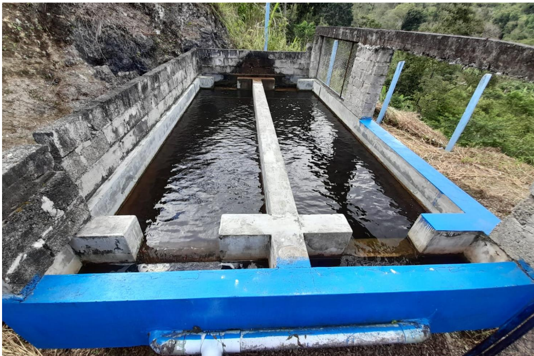
Foto N° 2. Sedimentador de la Planta de tratamiento de agua potable
