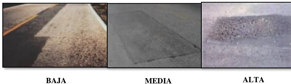
Figura 5: Niveles de las fallas de reparación.
