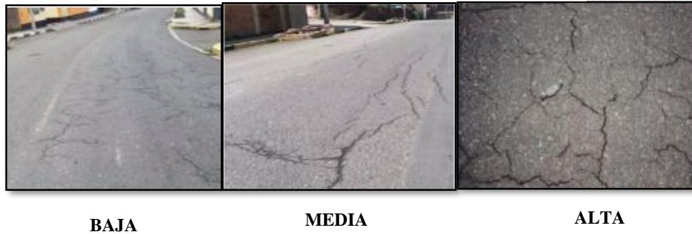
Figura 3: Grietas de piel de cocodrilo.
