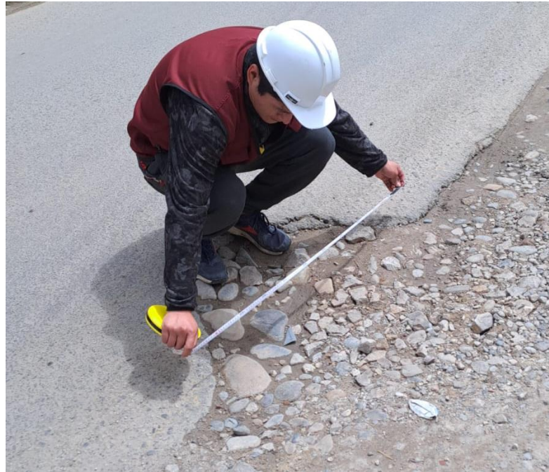
Figura 226: Medición de falla de borde UM-06
