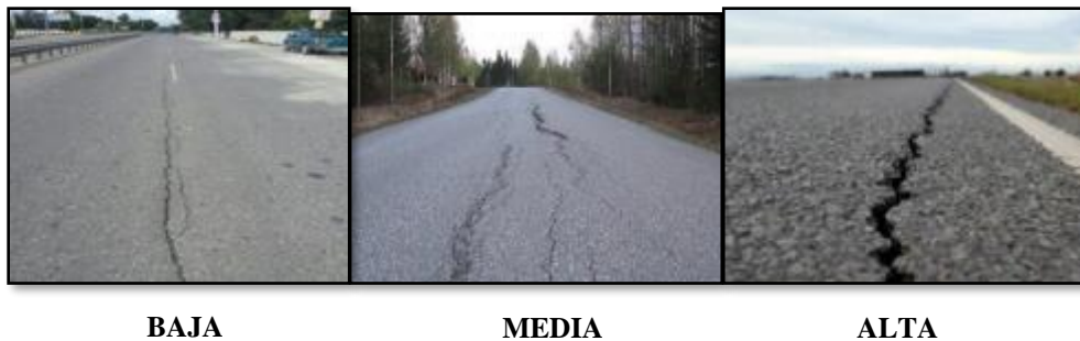
Figura 7: Niveles de las fallas de fisuras transversales.
